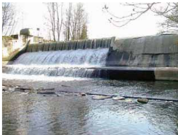
Abb. 76: Das Ausleitungswehr in Auroldmünster (Querbauwerk 1-43 im Wehrkataster von GUMPINGER & SILIGATO 2006) unterbricht das Gewässerkontinuum
