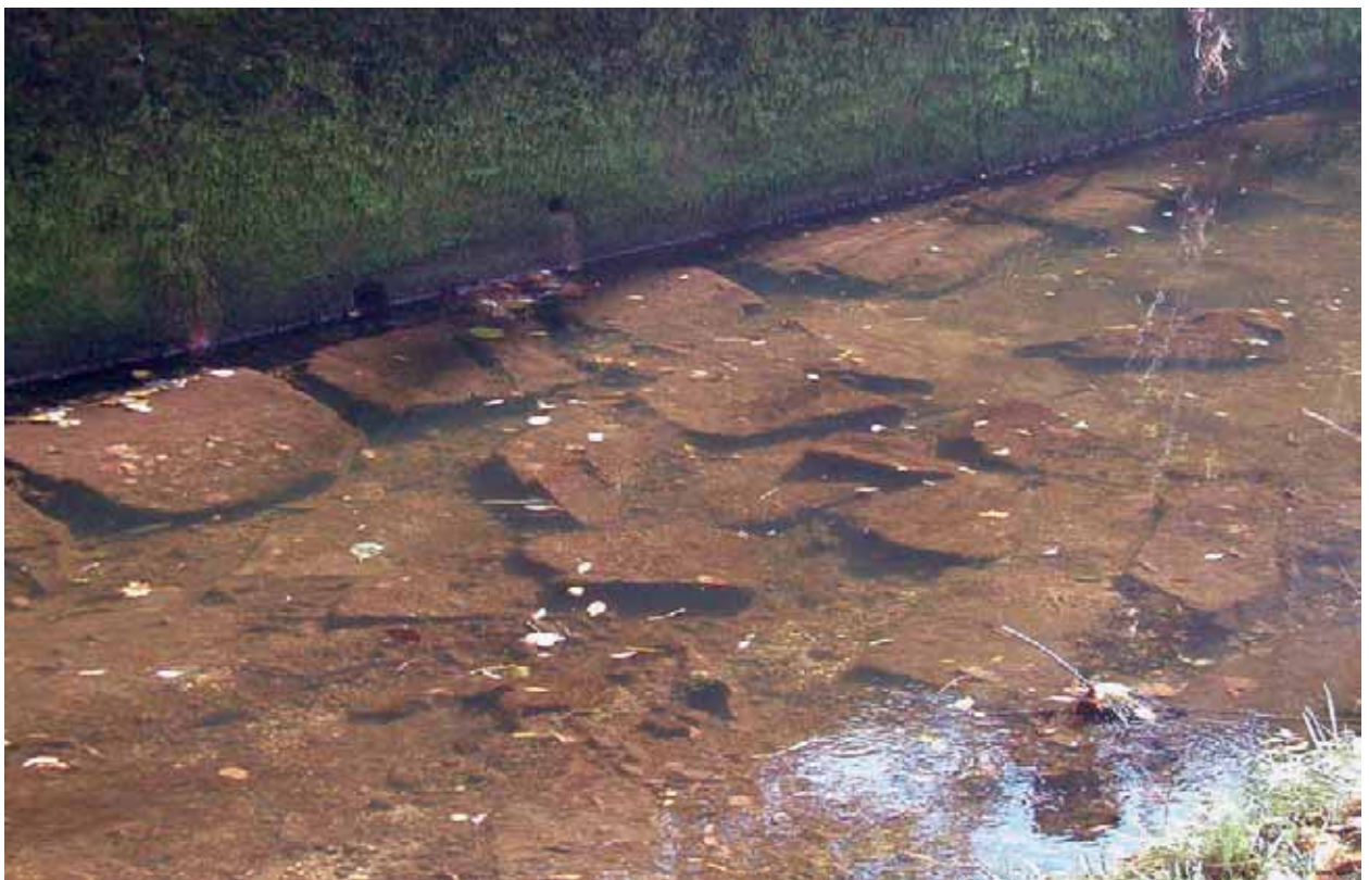
Abb. 5: Beispiel für die strukturelle Veränderung der Gewässermorphologie (Rieder Bach): Sohlpflasterung und betonierte Ufermauer
