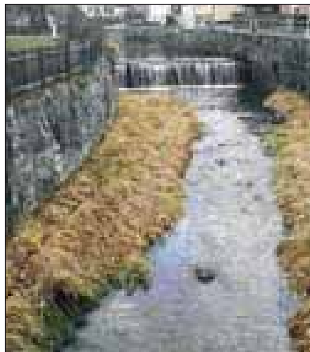
Abb. 15: Die Feldaist wird durch das Stadtzentrum von Freistadt in einem kanalisierten Bachbett geführt
