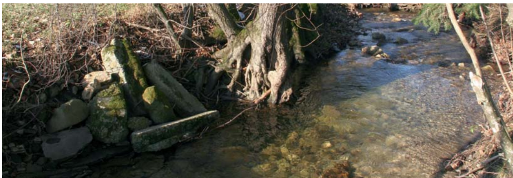
Abb. 91: Prallhangsicherung im strukturreichen Unterlauf des Ramsauerbaches.
