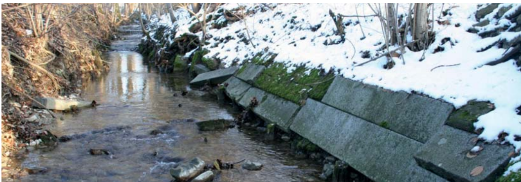
Abb. 92: Lokale massive Sicherung der Ufer des Zeller Baches flussab des Ortsgebiets Zell am Moos.
