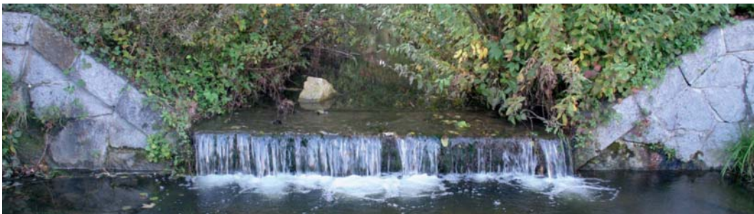
Abb. 4: Ein abgelöster Wasserstrahl ist für die aquatische Fauna nicht durchwanderbar (Foto: Höribach).
