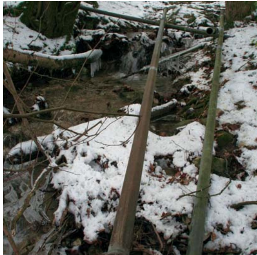
Abb. 116: Rohrleitungen zur Ausleitung von Wasser aus dem Steiningerbach ohne aktuelle Nutzung sollten entfernt werden.
