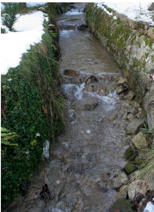
Abb. 86: Alte Ufersicherungen an Prallhängen im Bach in Hauben.
