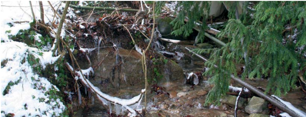
Abb. 25: Geknickte Rohrleitungen oberhalb des Untersuchungsbereichs des Steiningerbaches.
