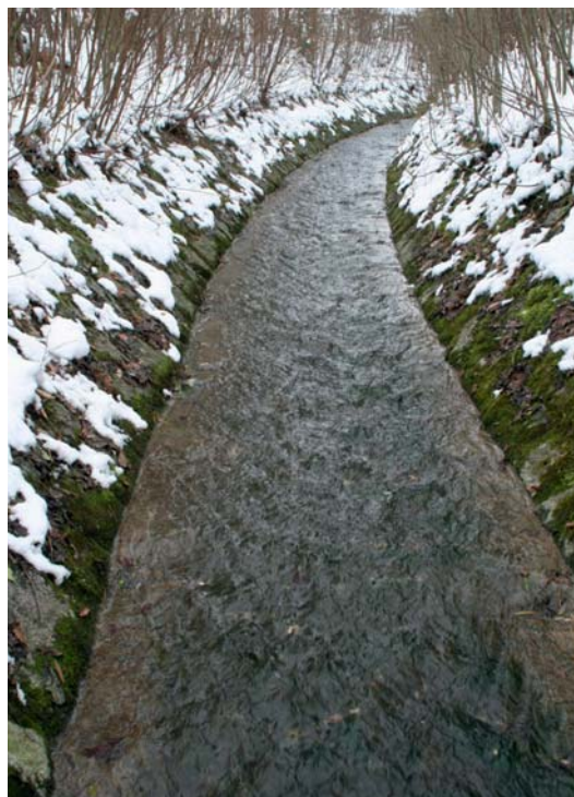
Abb. 83: Sowohl die Ufer als auch die Sohle des Hausstättergrabens sind massiv verbaut.
