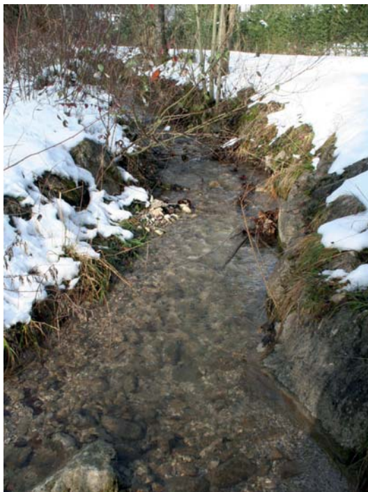
Abb. 27: Steinsicherungen im Bereich des mündungsnahen Privatgrundstücks am Bach bei Wildeneck.
