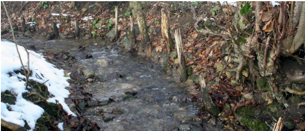
Abb. 85: Alte Ufersicherungen an Prallhängen im Bach in Hauben.
