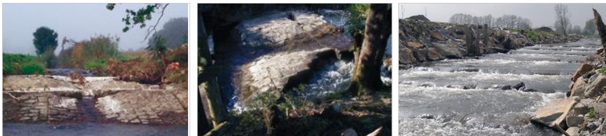
Abb. 22 Desolante Mündungsrampe des Leitenbaches (rechts und Mitte) und aufgelöste Rampe nach dem Umbau (links) (Quelle: ULLMANN et al. 2009).
