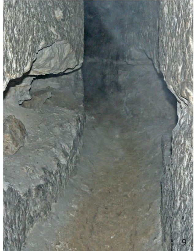
Abb. 9: Unregelmäßige Aushöhlungen an beiden Stößen bei ca. 46 m mit ca. 1 m Tiefe und 0,5 m Höhe (Blick in Richtung Mundloch).
