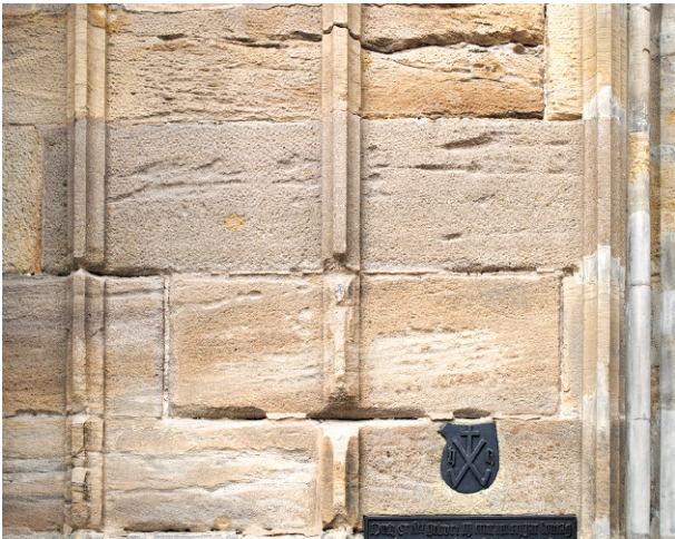
Abb. 3. Mauerwerk an der Südseite der Kirche St. Marien in Zwickau mit grauen und gelblichen Kohlesandsteinquadern.
