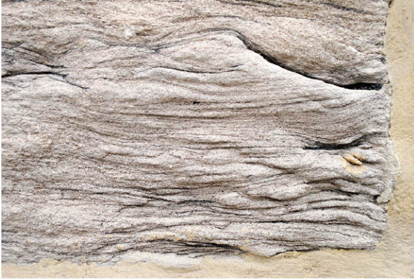
Abb. 10. Auswittern von Kohlelagen im Sandstein, Schloss Planitz (Fassade im Innenhof).
