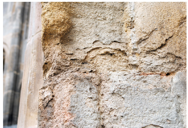
Abb. 13. Gipskrusten auf der Sandsteinoberfläche verursachen dahinter liegende Mürbzonen und Materialverluste.
