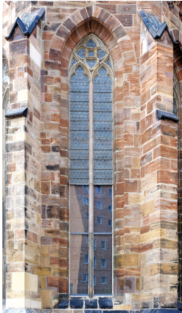
Abb. 4. Rote und gelbliche Kohlesandsteine am südlichen Schiff der Katharinenkirche in Zwickau.
