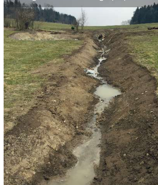
Geöffnete als naturnaher Bach gestaltete Drainage (AS)
