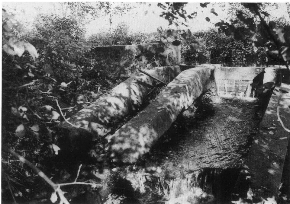
Abb. 3. Mühlenstauwehr mit Fischstappe in der Bieber bei Biebergemünd-Wirtheim. Das Fundament des Wehres ist unterspült, die Fischstappe nicht funktionsfähig.
