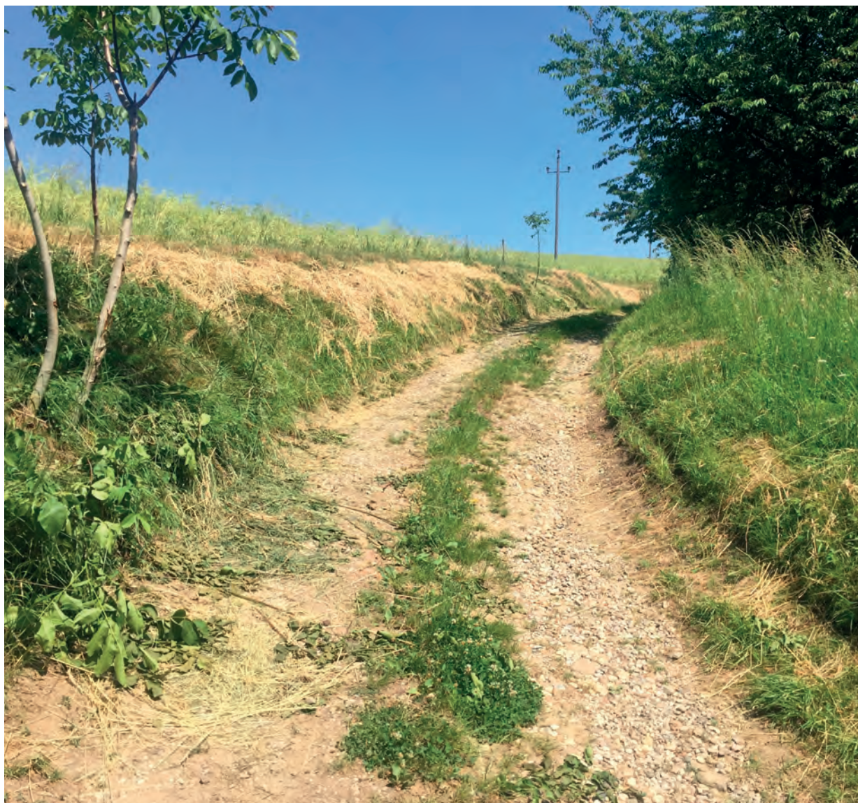
Feldweg mit offenen Bodenstellen in Fischlham.
