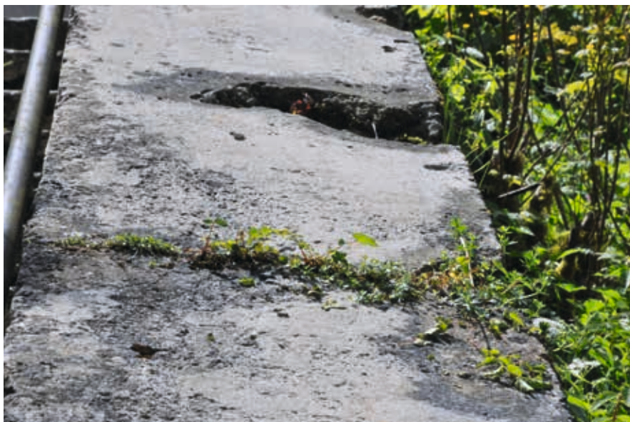
Abb. 36: Dehnungsriß und Frostausbuch in einer Mauerkrone aus unbewehrtem Beton, Hallstatt (Foto: Idam).
