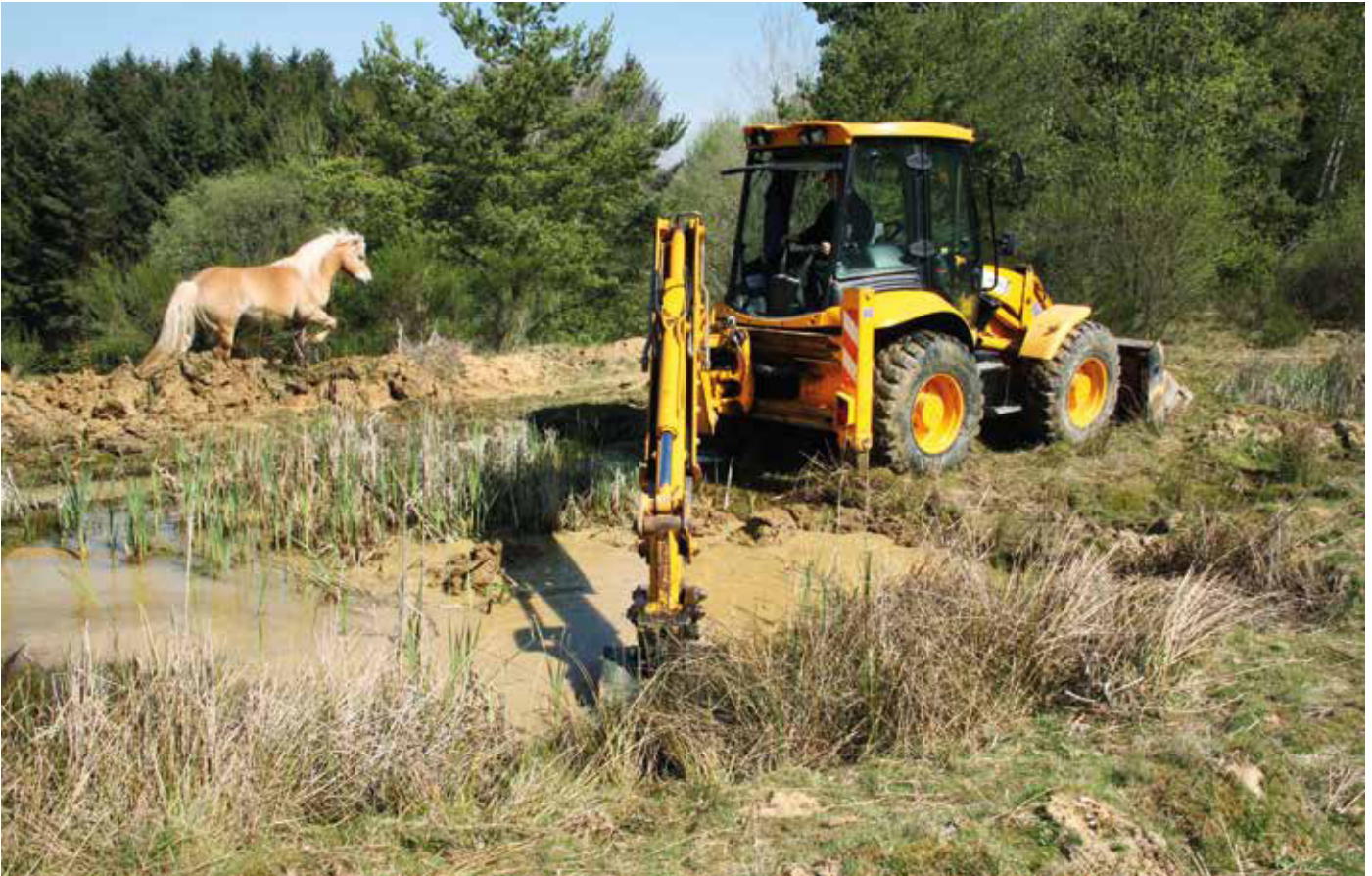
Abb. 2: Anlage von frischen Laichgewässern für die Gelbbauchunke in Reddighausen mit dem Baggerlader (Foto: H. Nicolay, 10.5.2017)
