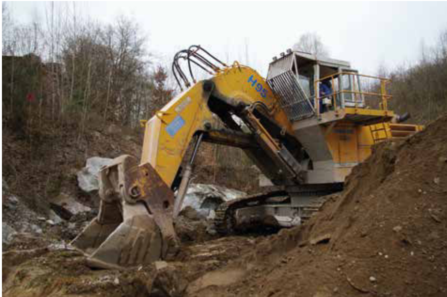
Abb. 3: Je nach verfügbarem Gerät wurden Kleingewässer durch Radlader oder Bagger verschiedener Größen angelegt, hier in einem Abbaugelände mit einem knapp 100-Tonnen-Bagger. (Foto: D. Heinz)
