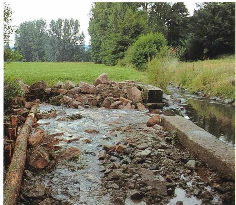
Taf. 12.3 (zu S. 118): Ehemaliges Schleifmühlenwehr am Bieberbach nach dem Umbau in eine sogenannte Sohlgleite. Aus dem Sohlabsturz wurde eine Sohl- gleite, die sich durch viele kleine Treppen und Nischen mit Ruhe- und Stillwasserzonen auszeichnet. Äsche, Bachforelle und viele andere Lebewesen des Bachs können seither das ehemalige Wehr passie- ren. Wanderfische gelangen nunmehr in ihr Laichgebiet.
