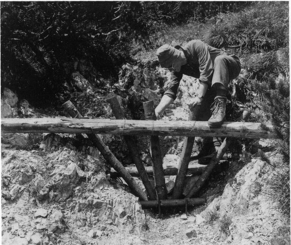
Abb. 8: Beispiel einer Erosionsrinne unmittelbar nach dem Einbau eines Holzrechen im August 1988.
