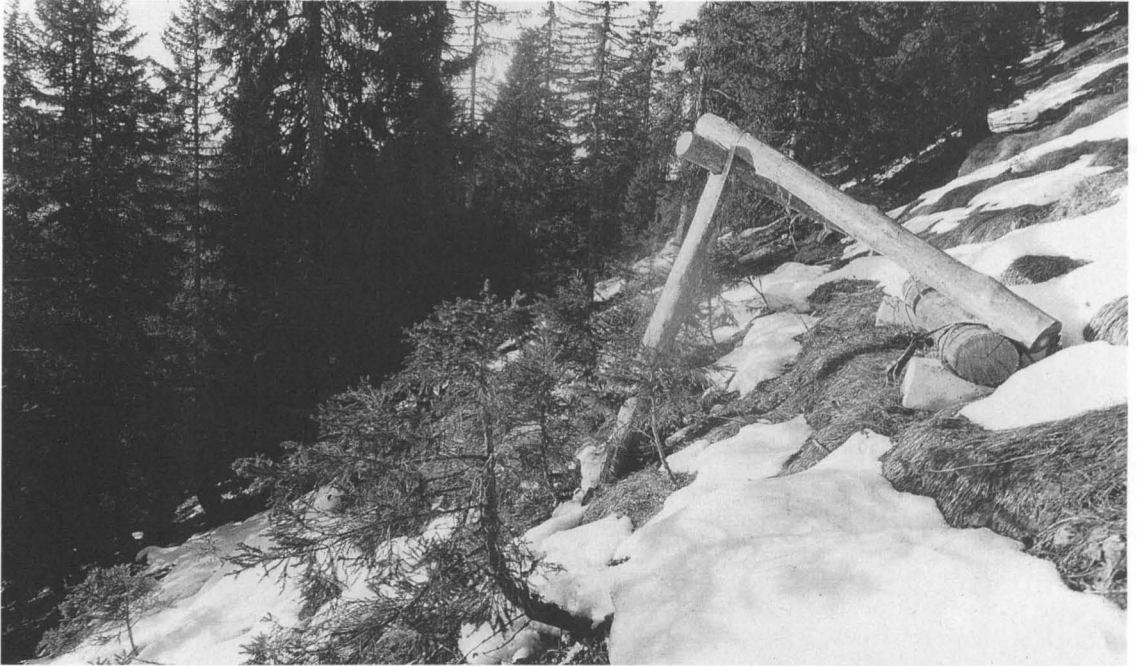
Abb. 18: Schutzwaldsanierung mit hölzernen Bauwerken. Viele Schutzwälder sind schon so lückig, daß der Schnee bergab kriechen und dabei junge Bäume brechen oder herausreißen kann. Durch hölzerne Bauwerke kann dies etwa 25 Jahre lang verhindert werden. Bis dahin muß der junge Wald so groß und so dicht sein, daß er die Schutzfunktion ausreichend übernehmen kann.
