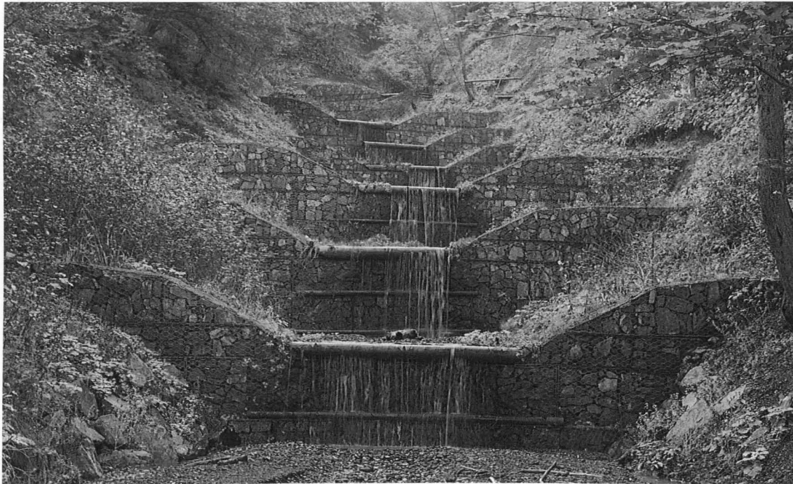
Abb. 19: Diese Sperrentreppe sichert die Bachsohle in einer Erosionsstrecke vor weiterer Eintiefung. Sie stützt zugleich die Hänge und mindert so übermäßigen Geschiebeanfall.
