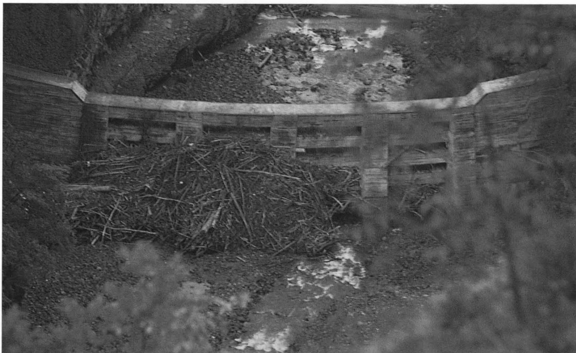
Abb. 20: Neben dem Geschiebe ist Wildholz eine besonders große Gefahr für menschliche Siedlungen und Verkehrswege. Speziell gebaute Sperren halten das Holz zurück.
