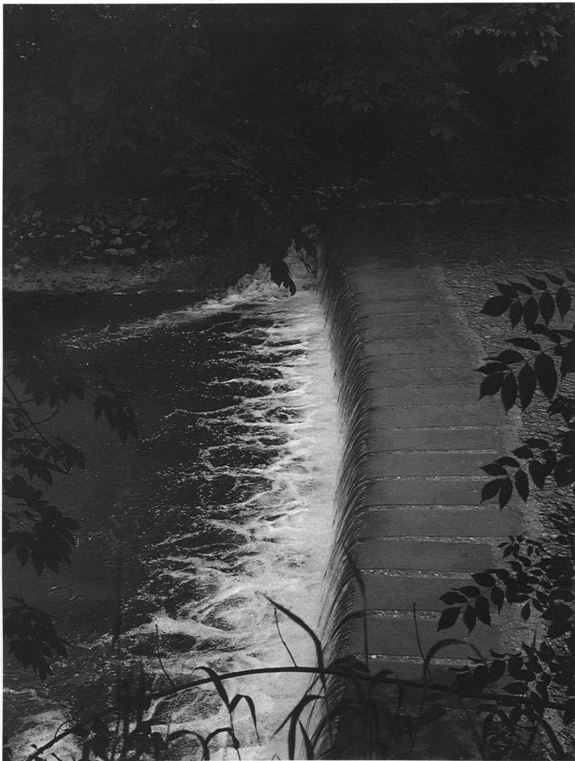
Abb. 27: In den im vorigen Jahrhundert zu Triftstrecken für Salinenholz ausgebauten Wildbächen wurde die Bachsohle mit niedrigen Schwellen aus Holz oder Stein stabilisiert.
