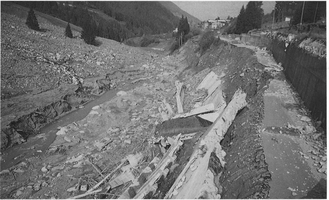
Abb. 16: Extreme Hochwasser mit starken Geschiebeeinstößen können zu schweren Schäden führen wie hier an der Straße nach Bormio.
