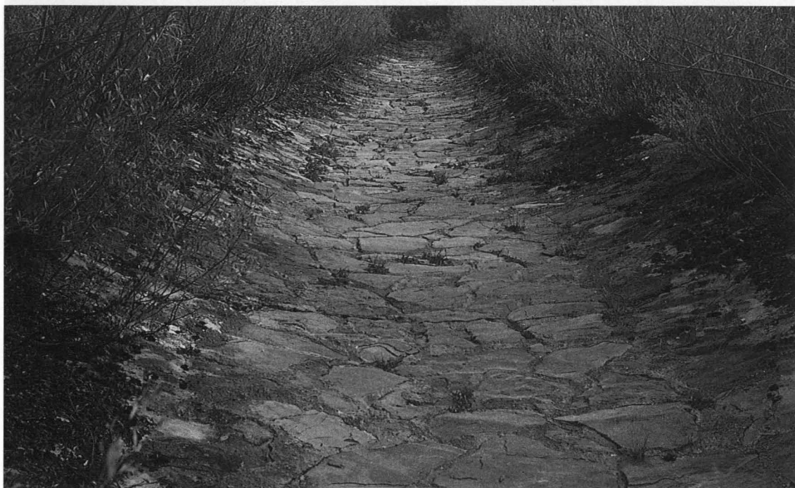
Abb. 21: Um das Ausbrechen von Wildbächen auf Schuttkegel zu verhindern, sorgen Stoßgerinne für den kontrollierten Abfluß von Hochwasser und Geschiebe.
