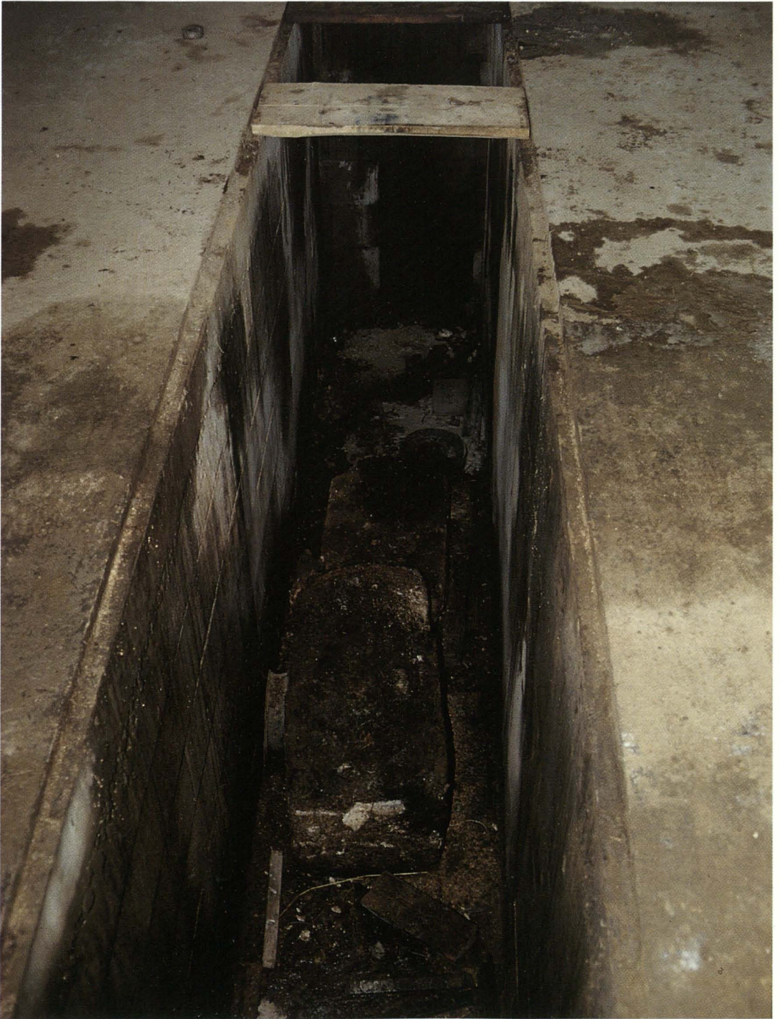
Foto 20: Im Tiefgeschoß der Talstation von Lift II befinden sich Montagegruben zur Wartung der Pistenraupen. Hier wurde eine Bodenverunreinigung durch Mineralöl festgestellt
