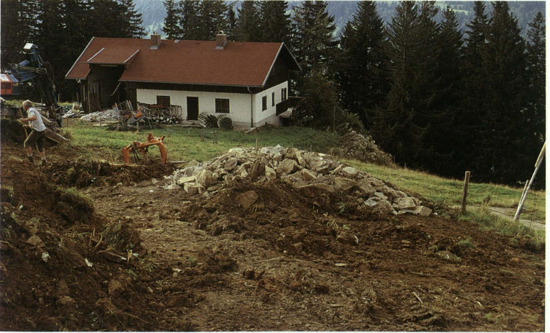
Foto 18: Aus dem Natursteinfundament des ehemaligen "Skihaserlstaes" wird ein "Steinhaufen" geformt, der als Ortszeuge an das alte Algebäude erinnern soll und zudem einen ökologisch vielseitigen Standort innerhalb der Alpfäche darstellt.
