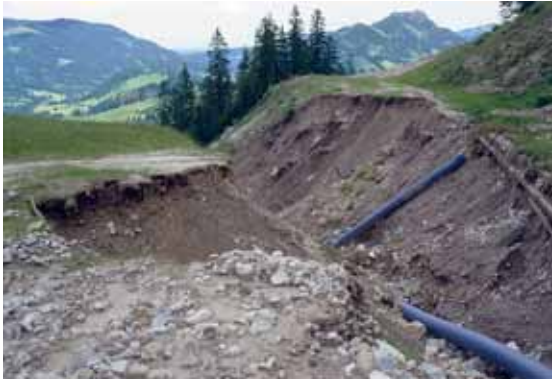
Bild 7: Massiver Erosionsschaden nach Geländeingriff
