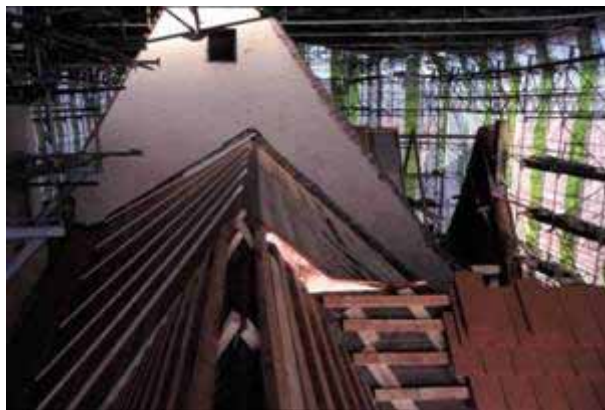
Abb. 5 Bei einem Wochenstubenquartier Großer Mausohren in Beyharting (Bayern, D) wurde im First eine dampfdurchlässige Folie angebracht, die einen Warmluftstau und den Erhalt der Kolonie ermöglichte. Foto: A. Zahn
