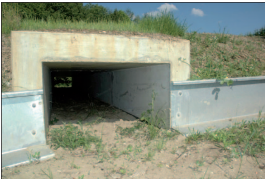
Abb. 5: Ausschnitt der 2007 fertiggestellten Tunnel-Leit-Anlage an der AW 103 Repnikteich in Velden. (Foto: Smole-Wiener/Arge NATURSCHUTZ)
