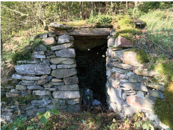
Der Unterstand vor der Reparatur. Foto: J. Pennerstorfer
