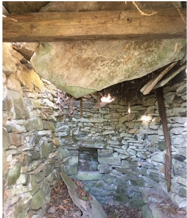
Das eingebrochene Dach mit den einhängenden Deckplatten. Foto J. Pennerstorfer
