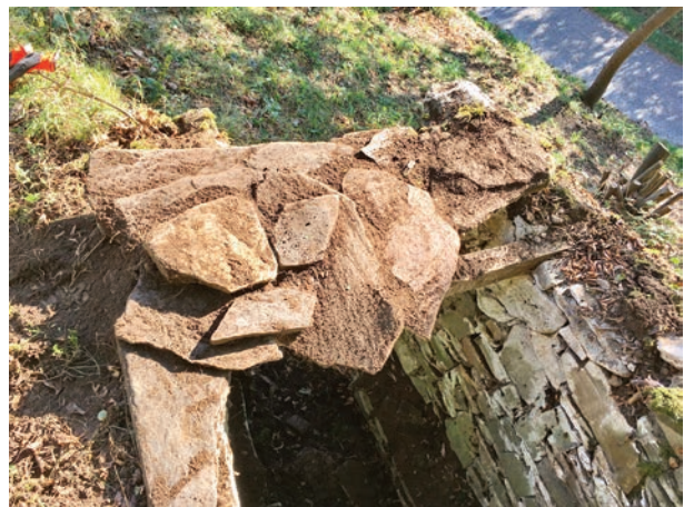
Reste des Plattendaches nach dem Entfernen des Erdreichs. Foto: J. Pennerstorfer
