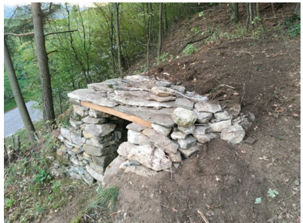
Das fertige Dach mit zum Teil wieder aufgebrachtem Erdreich. Foto: J. Pennerstorfer
