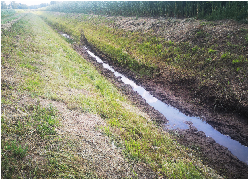
Abbildung 6: Der Abschnitt MT8 nach erfolgter Grabenunterhaltung. Die Grabensohle wurde auf gesamter Länge befahren, im hinteren Teil steht kein Wasser, 30.07.2022. – Figure 6. The ditch section MT8 after it was managed. The trench bottom has been run on. In the hindmost part the ditch didn't have standing water, 30-vii-2022. Photo: AF
