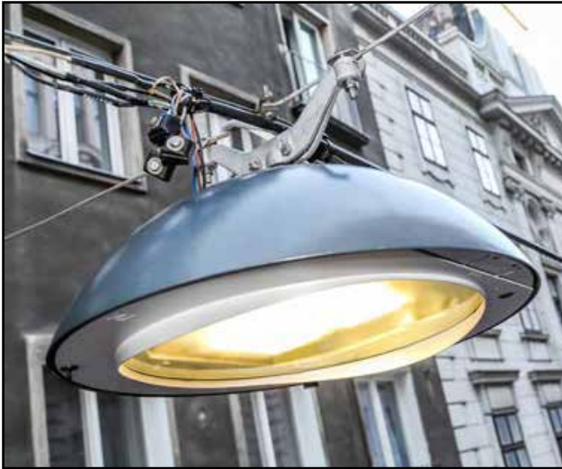
Abb. 5: Die neue Standardleuchte der Wiener MA 33. Gut erkennbar ist die am Rand montierte Blendschute.
