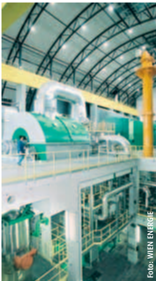
Blick ins Innere des kalorischen Kraftwerks Donaustadt
