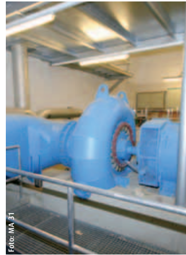
Die neue Turbine im „Trinkwasserkraftwerk Mauer“
