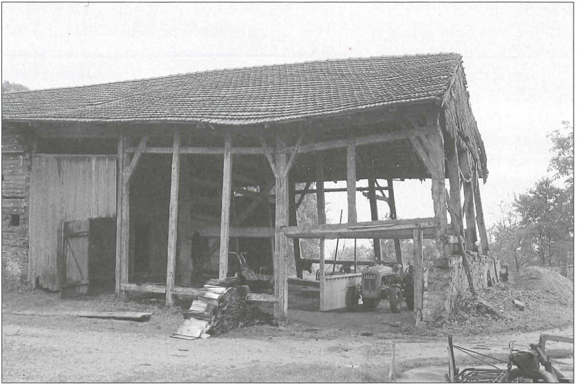
Bei der Abtragung sieht man deutlich den Ständerbau des Stallteiles (Foto: SFM, 902 Fl. 26-77).
