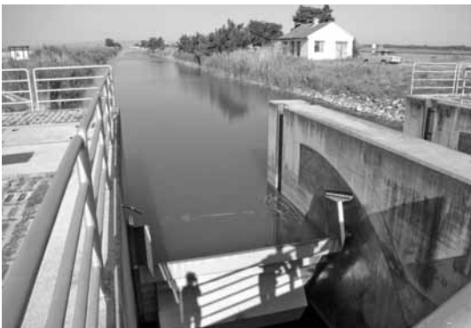
36. ábra. Fertőszéli-zsilip a Hanság-csatornánál (Fotó: ÉDUVIZIG)
