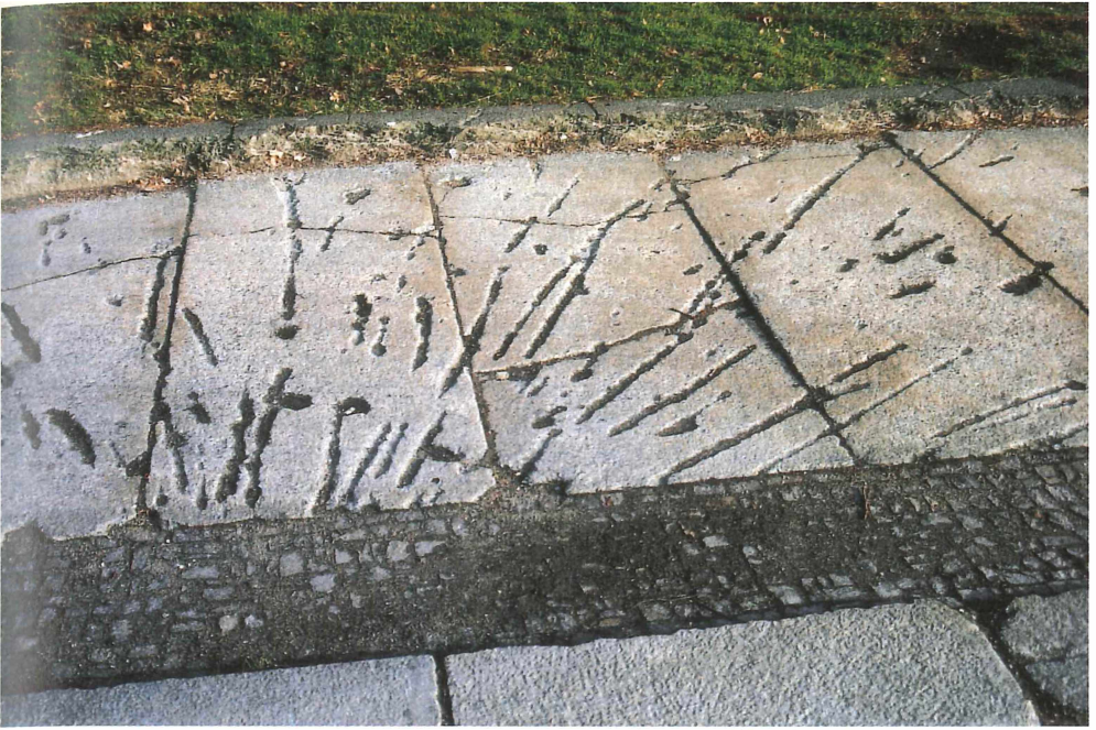
Abb. 3. Splitterfurchen (Ausschnitt) auf den Gehwegplatten aus Lausitzer Granodiorit („Granit“) unweit der östlichen Ecke Wilhelm-Seyffert-Strasse/Beethovenstrasse in Leipzig. Foto: 1. 1. 1998
