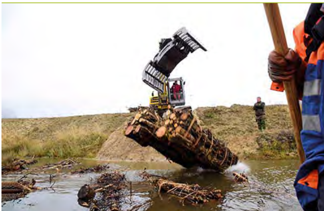
Abbildung 1: Mit insgesamt 800 Totholzbündeln wurden Uferzonen in acht Baggerseen in Niedersachsen strukturell aufgewertet. © Anja Gruner
