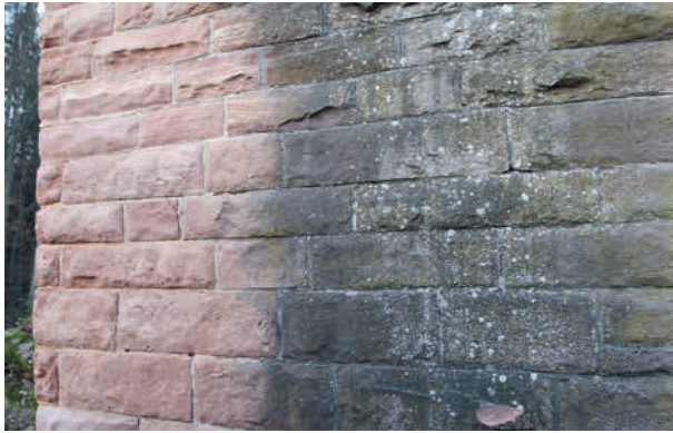
Abb. 11: Die anlässlich der Restaurierung 1960 aufgebauten Mauern sind gut zu erkennen. Nur wo Wasser herunterrieselt, haben sich Algen und Flechten angesiedelt.
