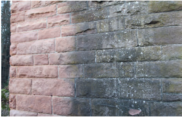
Abb. 11: Die anlässlich der Restaurierung 1960 aufgebauten Mauern sind gut zu erkennen. Nur wo Wasser herunterrieselt, haben sich Algen und Flechten angesiedelt.
