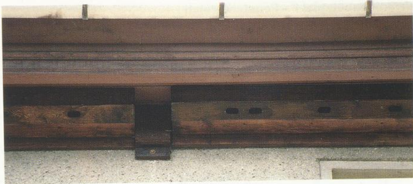
UNIKASTEN-Holz unterhalb der Dachtraufe, Chemnitz/Nevoigtstr. 42.
