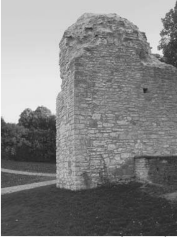
Abb. 8: Durch rücksichtslose Mauersanierung wurde das bedeutendste Vorkommen von Balea perversa in NRW fast vollständig zerstört (Sparrenburg bei Bielefeld). (Foto: H. SCHWER).
