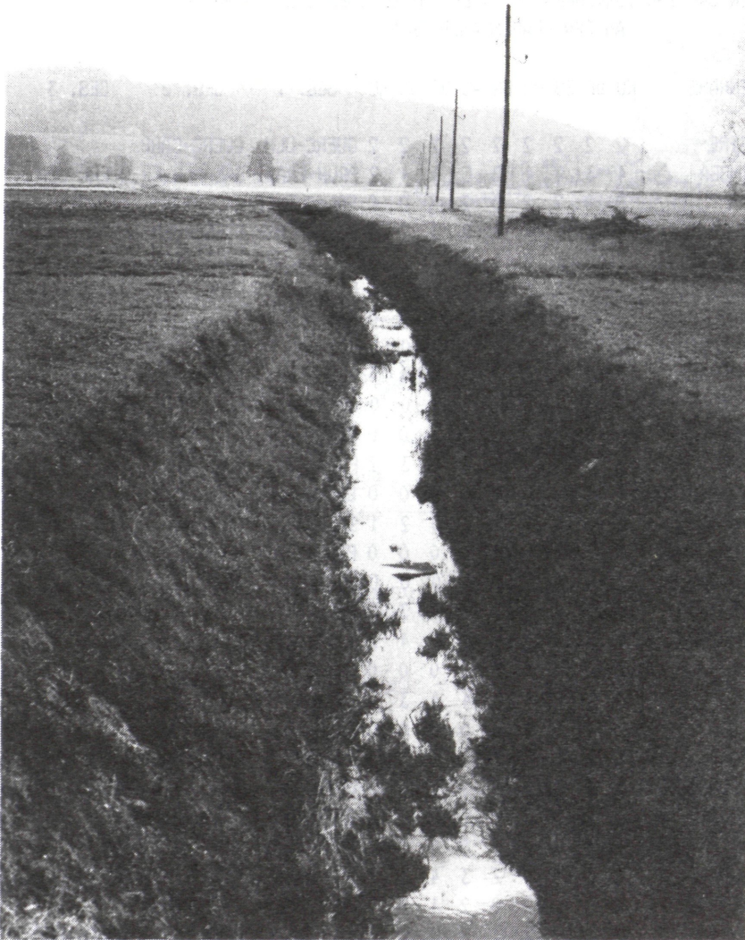
Abb. 5: Harte Regulierungsform des Ottersbaches bei Unterzirknitz ohne Ufergehölzpflanzung; lediglich im Ortsgebiet wurden einige Mammutbäume (!) angepflanzt. Die starke Verkräutlungstendenz durch die fehlende Beschattung und der ungehemmte Düngemittelabfluß fördern die Auflandung und erfordern oftmalige Instandhaltungsmaßnahmen.
