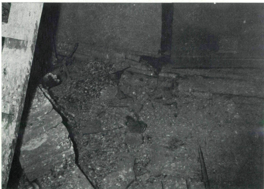
Abb. 2: Spalten und Ritzen im Mauerwerk in denen Wanzen, Taubenzecken und Vogelmilben leben.
