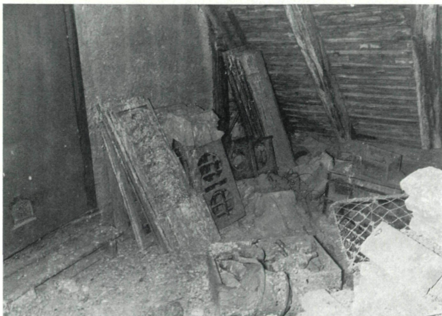
Abb. 1: Taubenbrutplatz auf einem verwahrlosten Dachboden.
