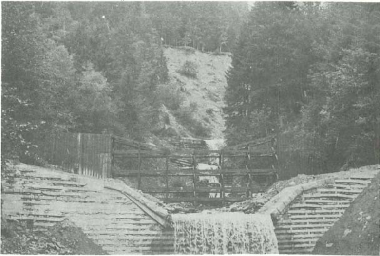
Abb. 19: Gitterrostsperr im Dürnbach bei Neukirchen im Oberpinzgau. Der durch beidseitigen Talzuschub hervorgerufene Seitendruck zeigt sich an den geborstenen Balken im Flügel der Stahlbeton-Fertigteilsperre (im Vordergrund rechts im Bild)
