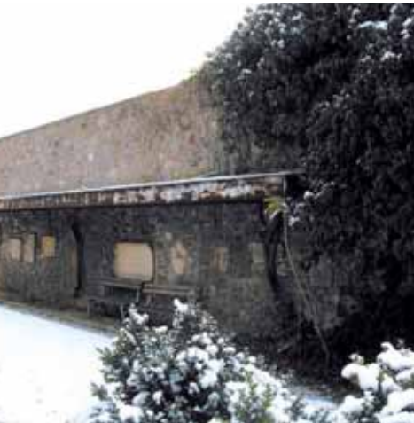
Linzer Schlossmuseum, Innenhof. Trotz breiter Überdachung verwittern besonders die Sandsteine zusehends. Das geologische Gutachten empfiehlt eine rasche Herausnahme
