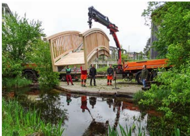
Der Steg über den Teich vor dem Nationalpark Zentrum Molln wurde von Mitarbeitern der Nationalpark Tischlerei generalsaniert.
