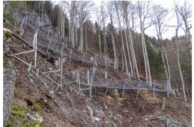
Die Anbruchverbauung der Kleinen Waidtallawine
