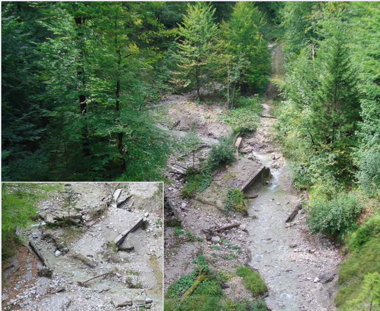
Verklaute Brücke im Weißenbach:
