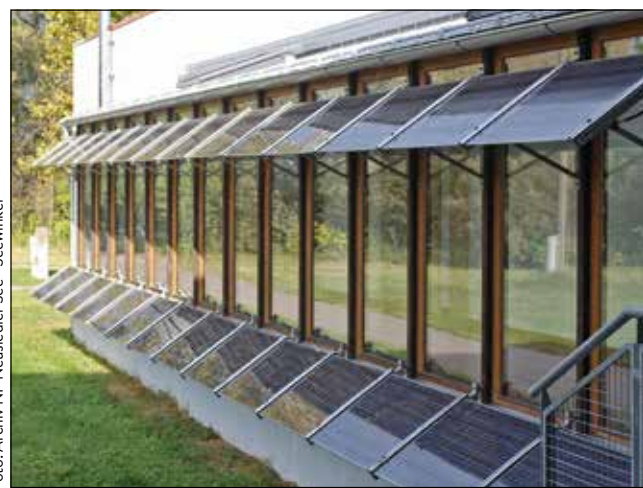
Eine der ersten Photovoltaikanlagen im Nordburgenland wurde 1995 am Nationalpark-Infozentrum installiert.
