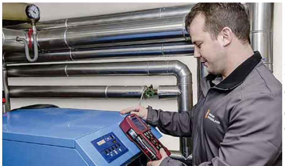
Foto: Energie Burgenland
