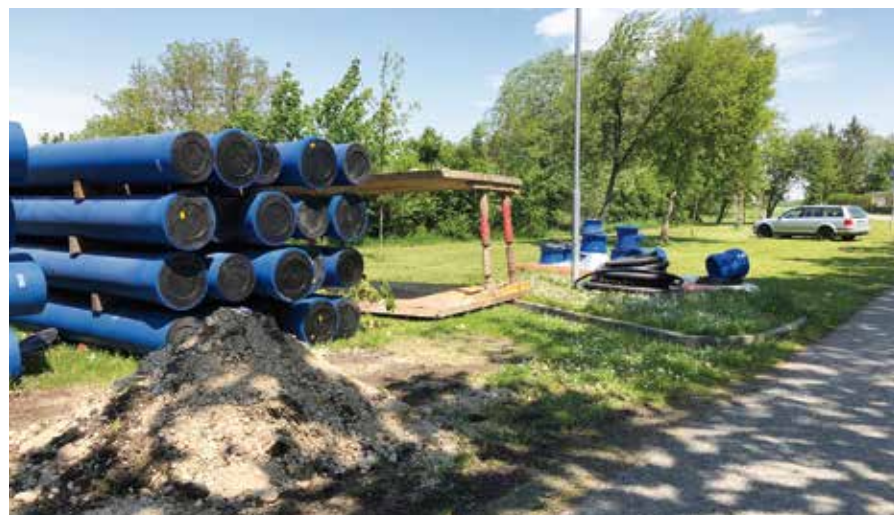
■ Rohrlager im Bereich Stöttera bei der Sanierung der TL 150 und 151 Antau – Stöttera
