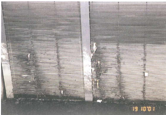
Fischpass Iffezheim: Aalstücke in den Beruhigungslamellen für das abströmende Wasser aus der Lockstromturbine (Fotos: P. Jäger)
