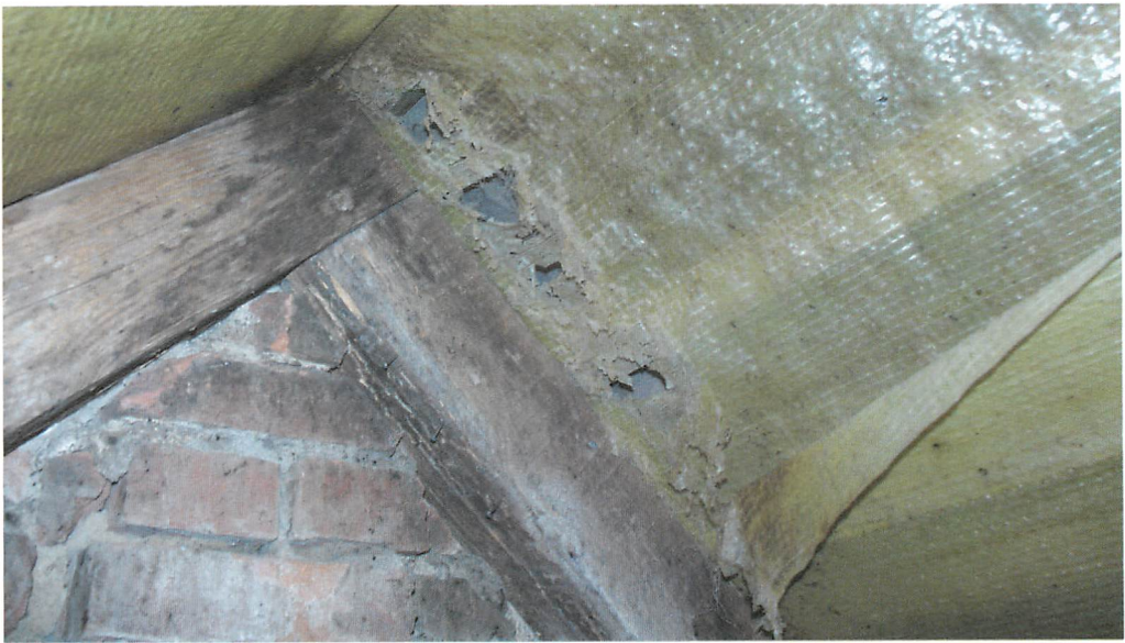
Abb. 6. Gatow. Von Mausohren beschädigte Unterspannfolie im Dachfirstbereich. Aufn.: HEINO HAUF
