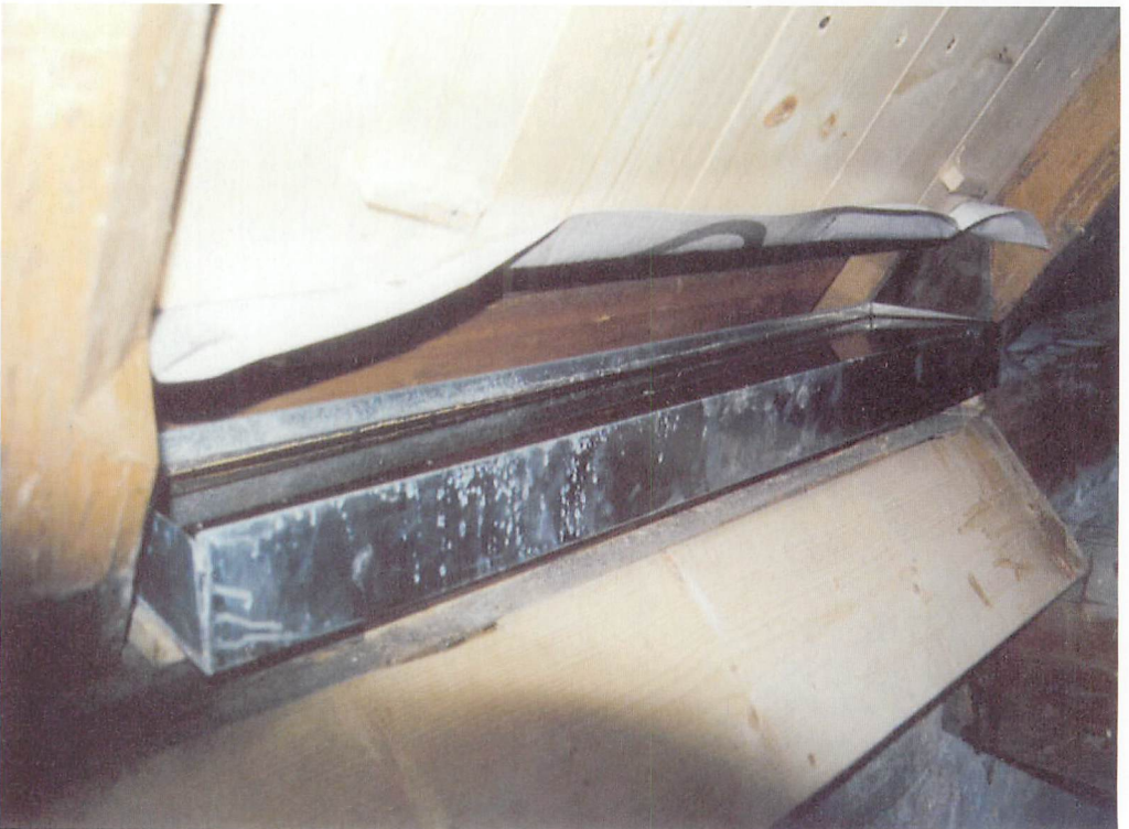
Abb. 13. Pfarrkirche Gehofen; geöffnete Kotrinne unter dem Dach. Aufn.: A. DANZ
