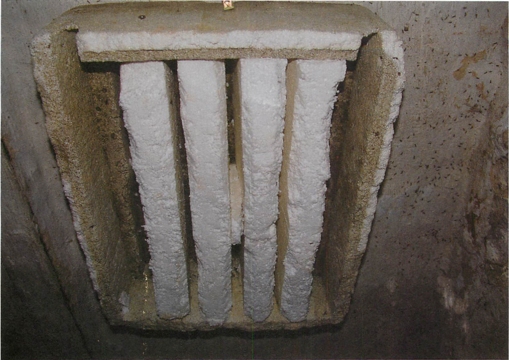
Abb. 4. Styropor-Kasten mit unterschiedlich breiten Spalten in der großen Bahnunterführung Görlsdorf.
