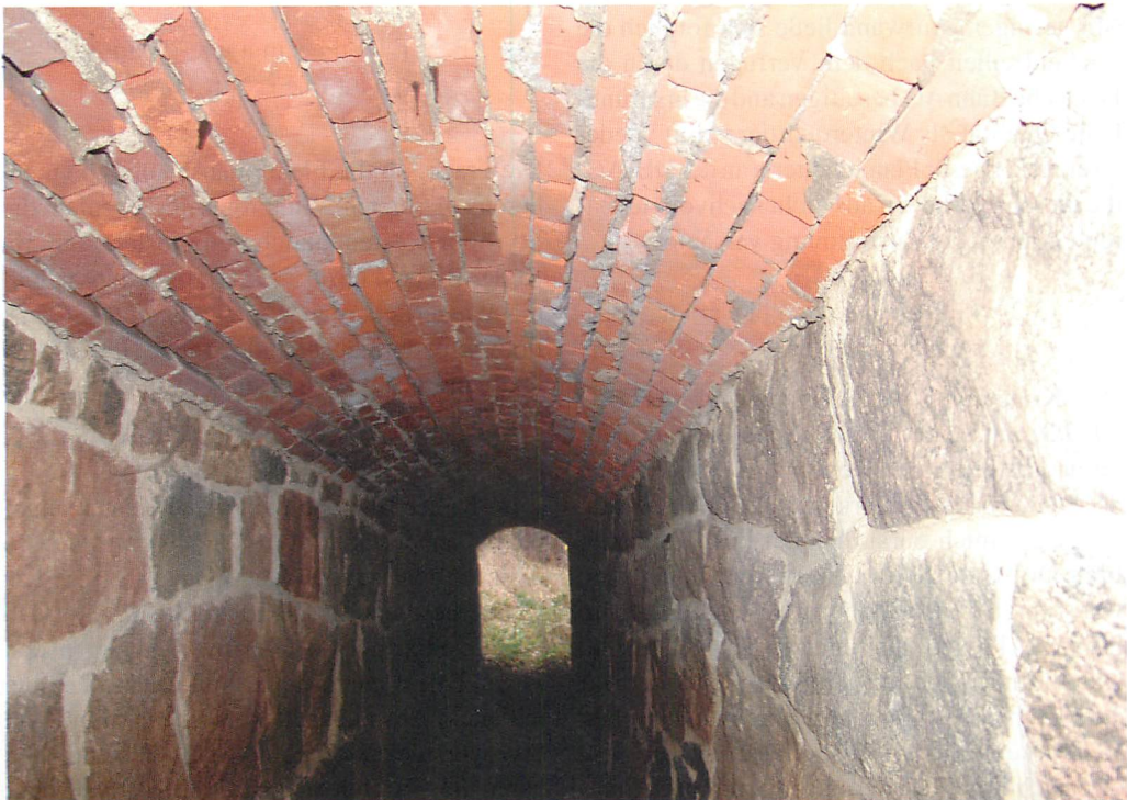
Abb. 3. Kleine Bahnunterführung Görlsdorf. Spalten im Gewölbe hier nicht verschmiert.
