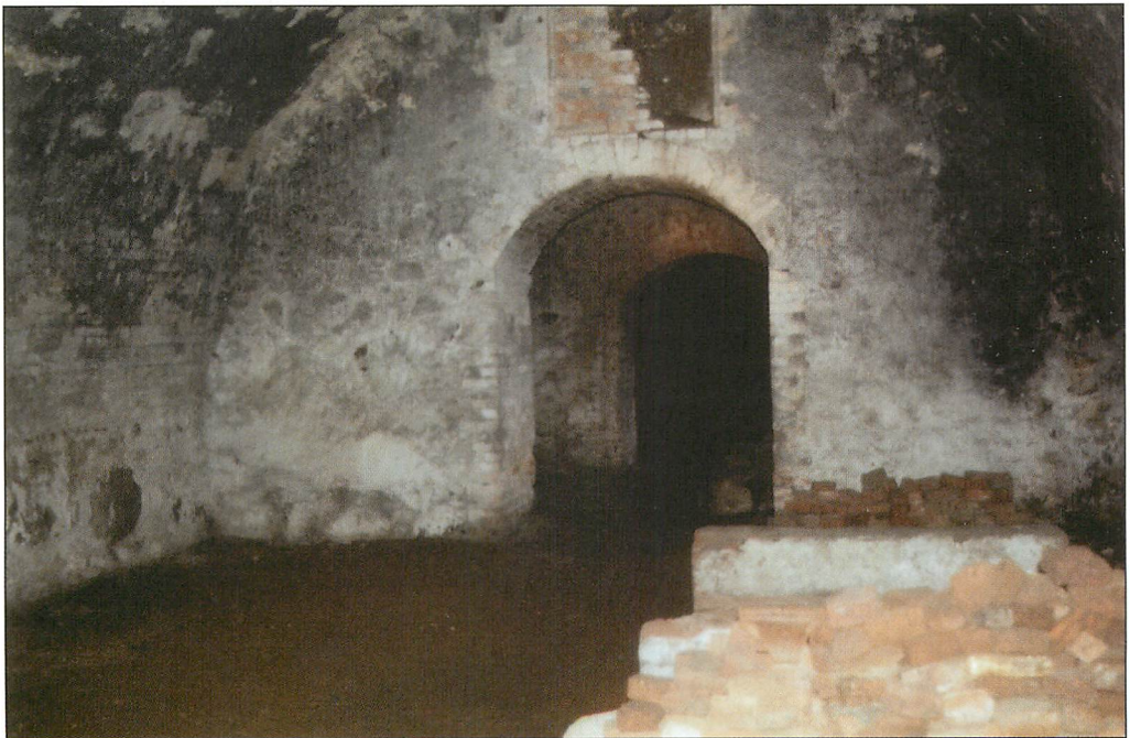
Abb. 3. Gewölbe unter dem Kellerberg („Bergkeller“/Raum I mit Verbindungen über Bogentore Richtung Eingang). Aufn.: M. NÄFE, 2005
