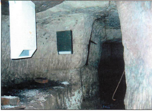
Abb. 5. Objektspezifisch angefertigte Starkfrosthabitate für die Decken- und Wandmontage in einem unterirdischen Hohlraum mit weitgehend geraden Decken und Wänden.
