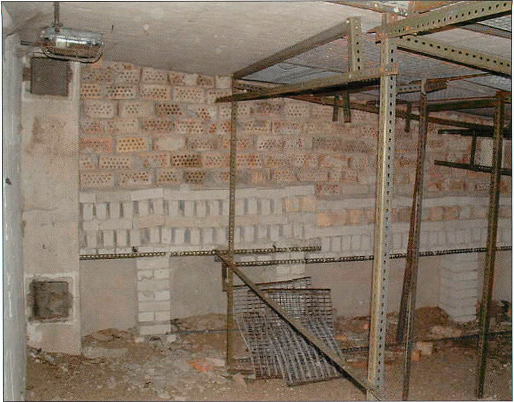
Abb. 9. Fledermausfreundliche Ausstattungen in einem der ehemaligen Raketenbunker. Die Braunen Langohren halten sich meist in den Spalten zwischen den Kalksandsteinen auf. Aufn.: O. BÜXLER
