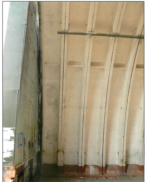
Abb. 5. Die Spalten zwischen den Betonsegmenten sind unterschiedlich breit, in einigen Hangars auch völlig abgedichtet.
