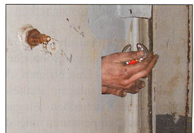
Abb. 20. Schloss am Bunker Spechtshausen-Mechlow. Hier wurde im Herbst 2006 die gesamte Türverankerung von Unbekannten herausgerissen..
