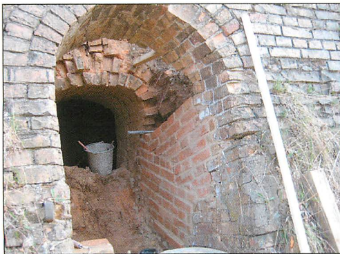
Abb. 38. Ringofen Schiffmühle: Eingestürzte Gewölbeteile und Öffnungen – Durchfrieren des Quartiers und Gefahr für die Quartierbetreuer.
