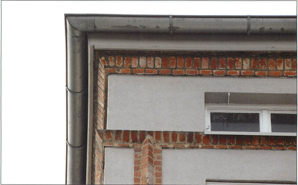
Abb. 4. Quartier B der Kolonie in Augsburg-Oberhausen. Der Ausflug befindet sich am Eck unter der Dachrinne. Aufn.: B.-U. RUDOLPH.
