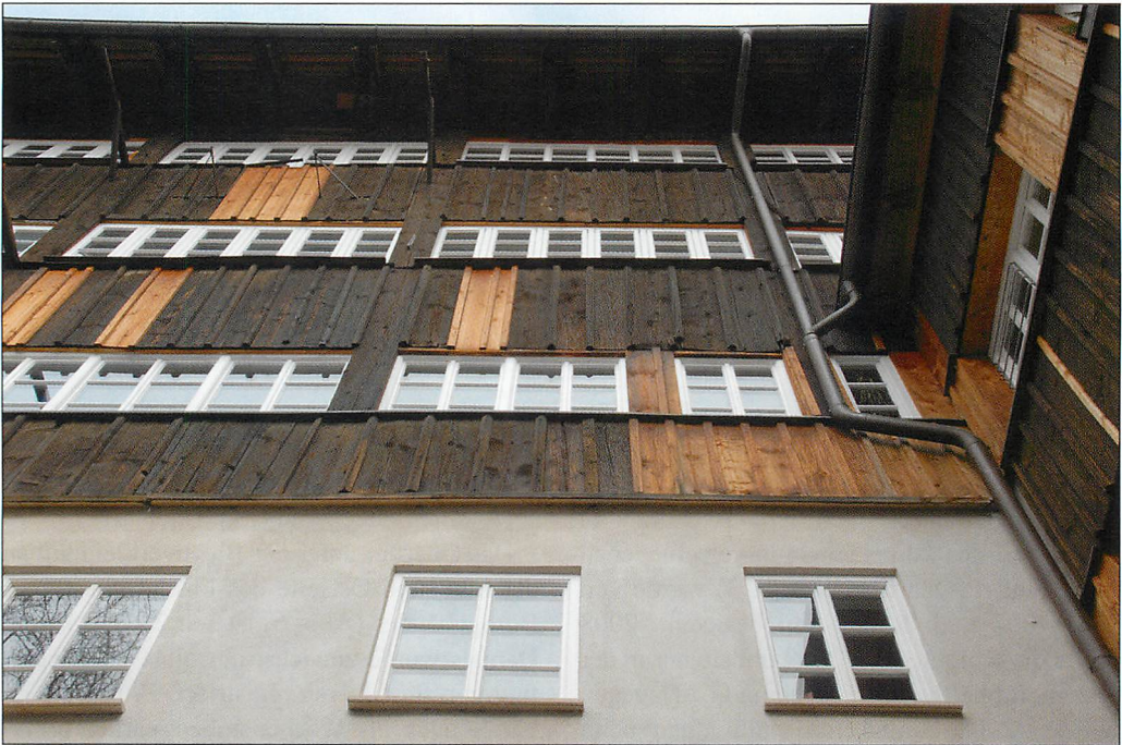
Abb. 7. Quartier der Weißbrandfledermaus im Zentrum von Augsburg. An mehreren Stellen unterhalb der beiden oberen Fensterreihen fliegen die Tiere aus, Aufn.: B.-U. RUDOLPH.
