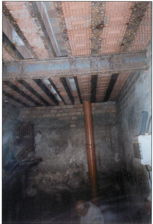
Abb. 10. Deckenansicht von Quartier Nr. 10 mit den Porotonbetten. An der hinteren Wand ist das Lüftungsrohr sichtbar.
